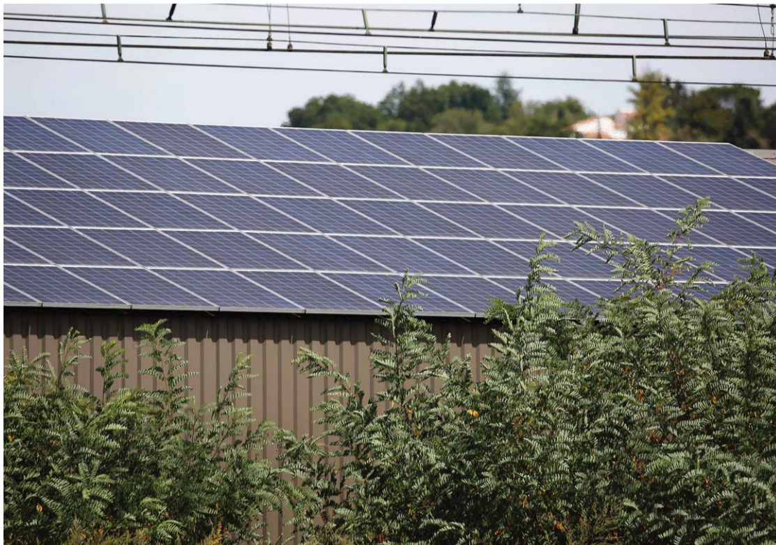
La location de la toiture sud pour l'installation de ces discrets panneaux a permis à l'association de boucler le montage financier du nouvel espace de vente. PHOTO THIERRY SUIRE
